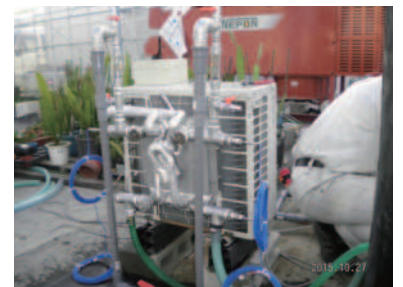
いちごハウス農家様による井水熱源 + 温水出力。クランを樹脂パイプで低温加熱、既設のカンキの重油使用量を大幅に削減。
