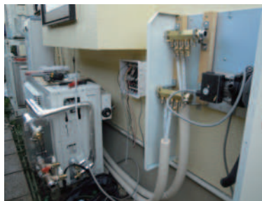
既設ガス床暖房のご自宅を改造、空気熱源タイプを増設。床冷房 + 床暖房化で省エネと快適環境を実現。
